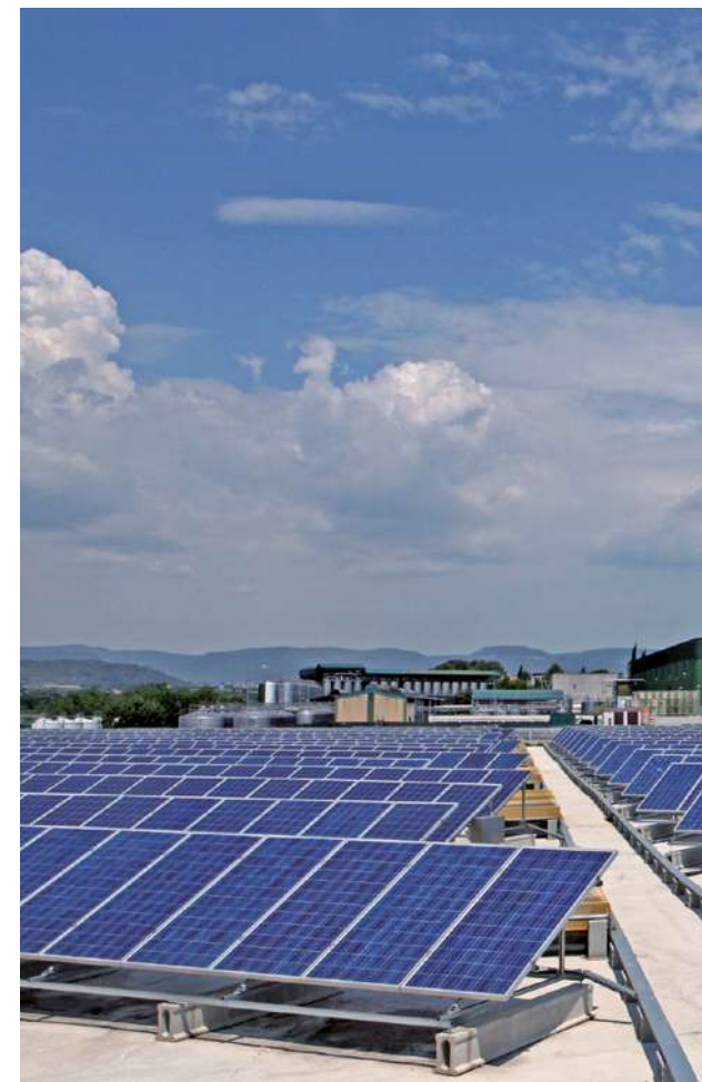
Instal·lació fotovoltaica al celler de Pacs del Penedès
